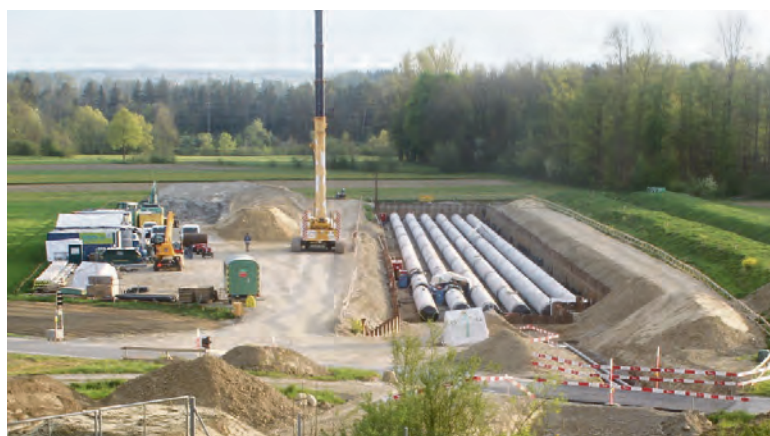
Mit dem Röhrenspeicher in Buhwil sorgt die TBW für genügend Gas-Reserven.
