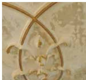
Nach der Trockenreinigung sind Wasserschäden sichtbar geworden
