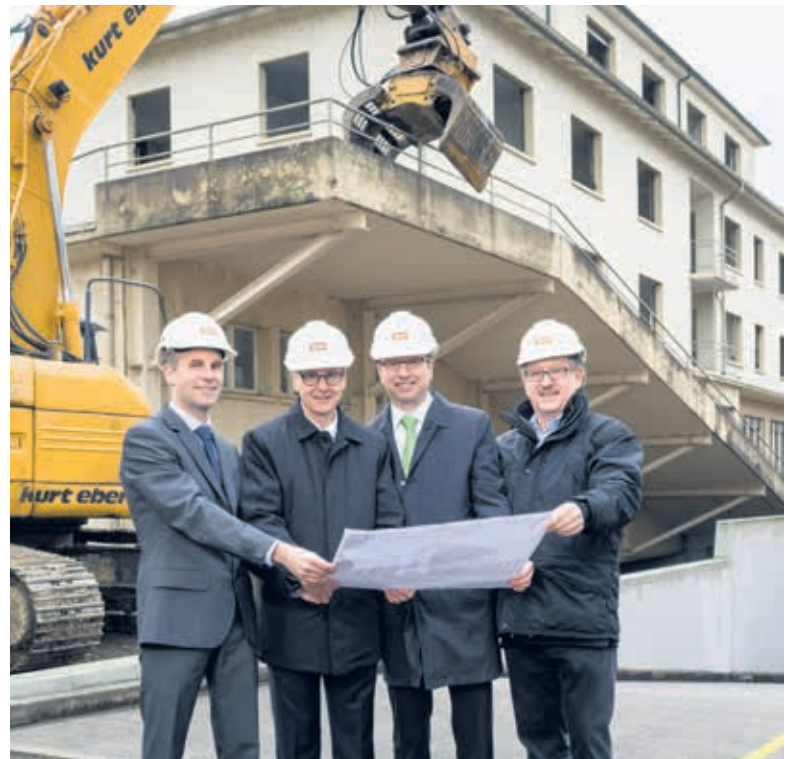
Andreas Lampel (Projektleiter TKB), Rolf Brunner (Mitglied der Geschäftsleitung TKB), Clemens Bühler (Mitglied der Geschäftsleitung HRS) und Norbert Nothhelfer (Projektleiter HRS) (von links) auf der Baustelle.
